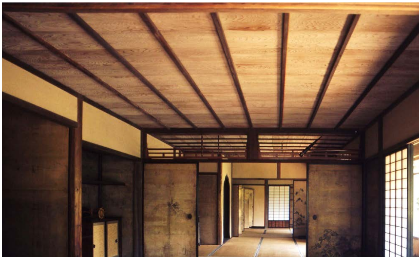
Figura 49. Techo de tableros y listones de la casa Rinsbunkaku del período Edo.
