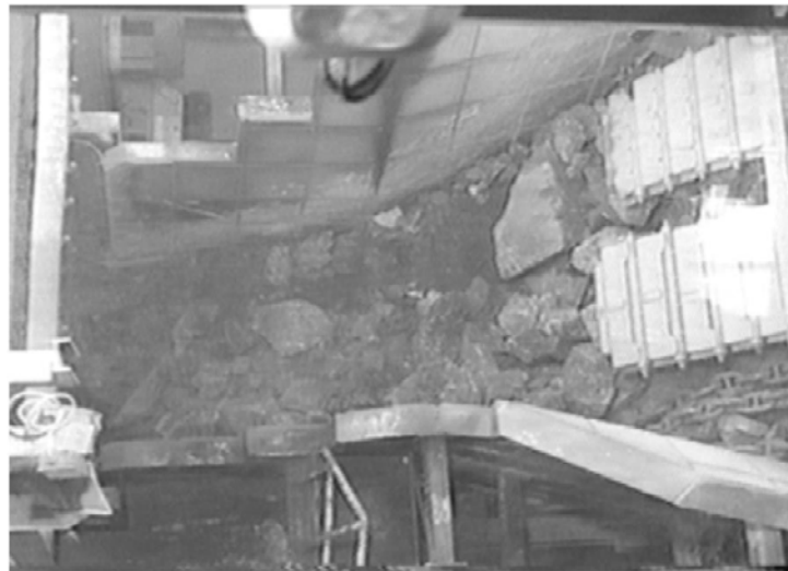
Figura 3.4. Un alimentador en funcionamiento.
