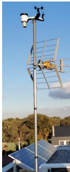
Figura 6-11. Instalación de la estación meteorológica.
